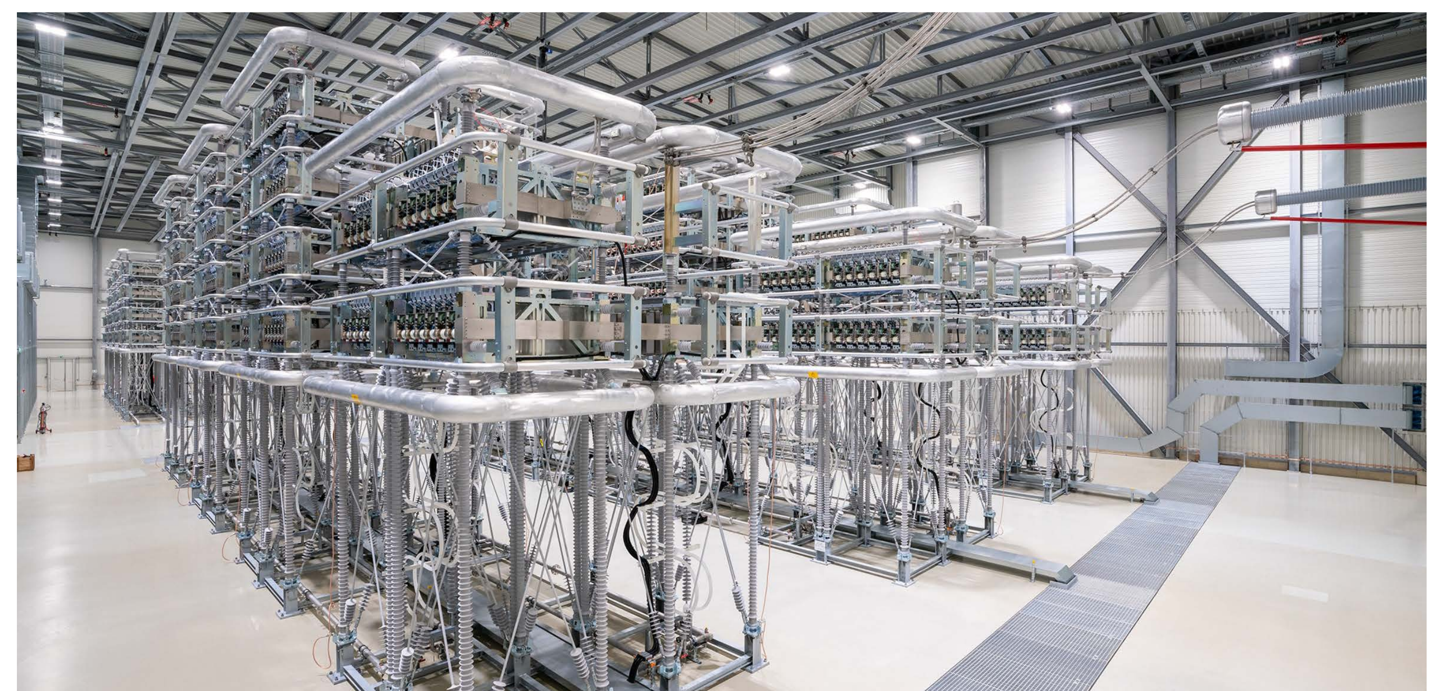
HVDC PLUS Converter (ALEGrO, Oberzier) | Bildquelle: Siemens Energy
